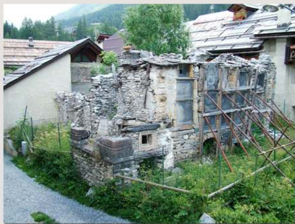
Un'immagine recente della Casa delle Lapidi: il degrado e le condizioni precarie non hanno ancora avuto del tutto il sopravvento sui tesori che custodisce.
