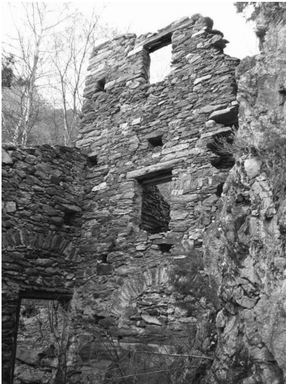
TAVOLA 7) Muro divisorio tra il primo opificio, probabilmente un mulino, e la pesta da canapa, a Oulme, Salbertrand.
