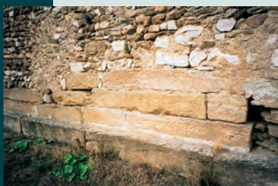
Il basamento del tempio si conserva per alcuni filari alla base della parete sud della chiesa.
